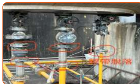
現況說明：高壓氣體儲槽設備側封膠帶脫落
