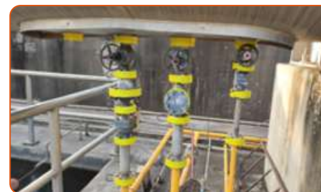
改善措施：測漏並更新膠帶
