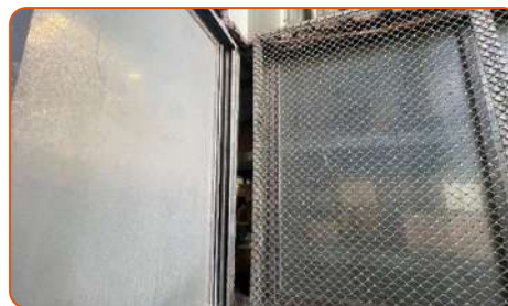
現況說明：一廠區 A 棟廠房保養一課 保養間外浪板破損
