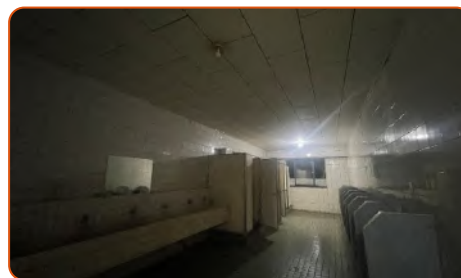
現況說明：一廠區 F 棟廠房廁所內電燈不會亮
