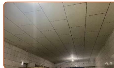
改善措施：電燈泡重新更換
