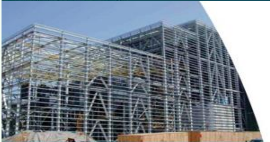
欣榮焚化爐 Xin Rong Incinerator 桃園 (Taoyuan) / 1,800噸
