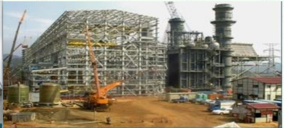
新桃電廠 Xin Tao Power Plant 桃園 (Taoyuan) / 2,500噸
